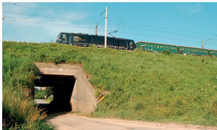
Wiadukt zburzony podczas remontu linii kolejowej w czerwcu 2018 r.
